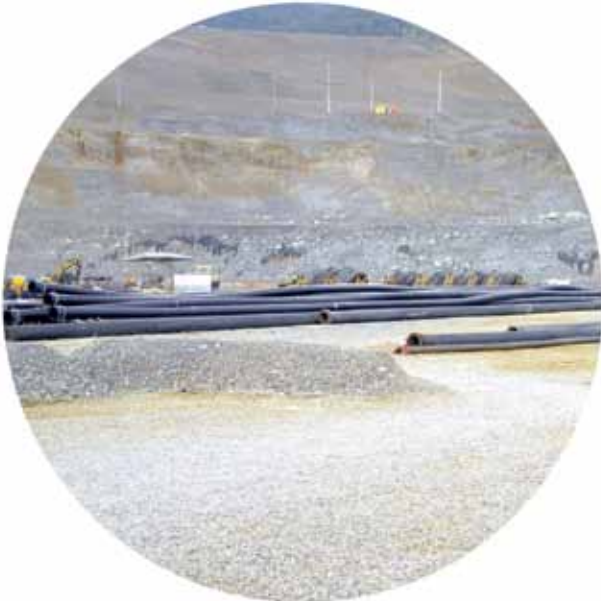
รูปที่ 4. การเตรียมก่อนการติดตั้งในเหมือง Pre-installation preparation of pipes
